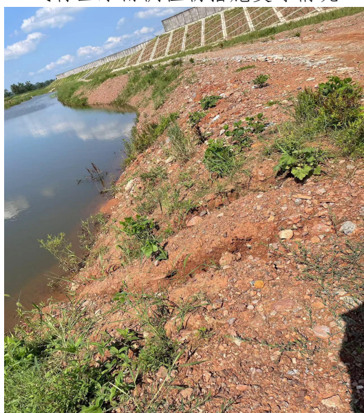
飞行区西北侧边坡水土流失
