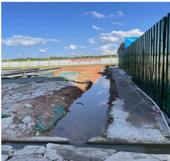
航站区临时排水沟
