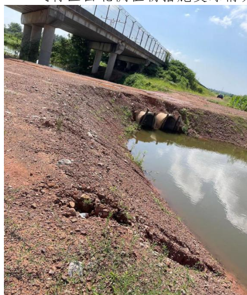
飞行区西北侧边坡水土流失
