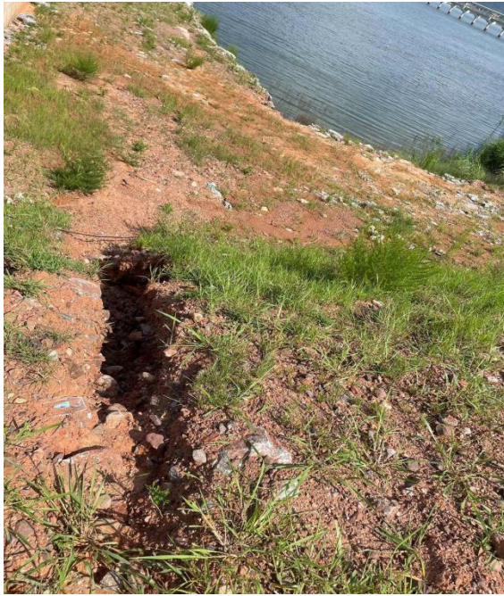
飞行区东南侧边坡水土流失
