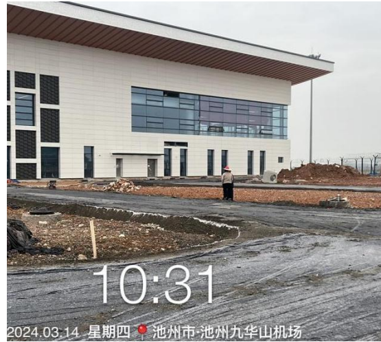
停车场区临时堆土未苫盖
