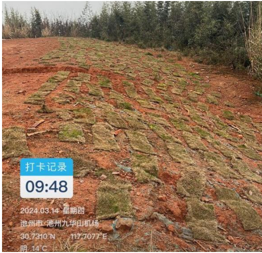
飞行区西北侧植被绿化不足
