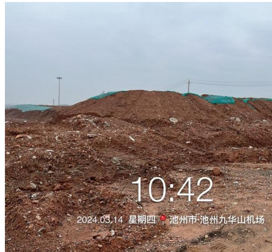
停车场区临时堆土苫盖不足
