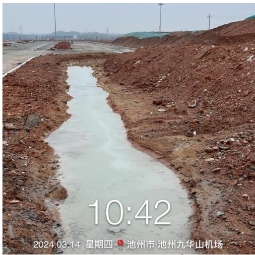
停车场临时排水沟及苫盖不足
