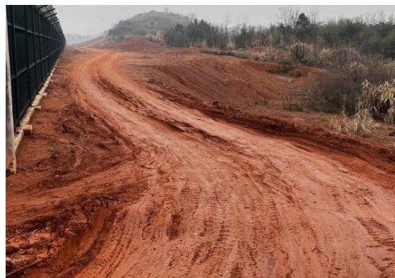
飞行区东北侧边坡存在大面积裸露
