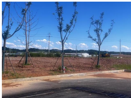
停车场区临时堆土未苫盖及裸露地面未进行密目网苫盖
