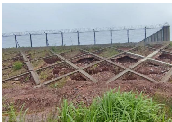
飞行区延长线段出现塌方
