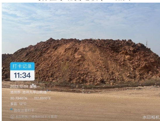
停车场区临时堆土未苫盖
