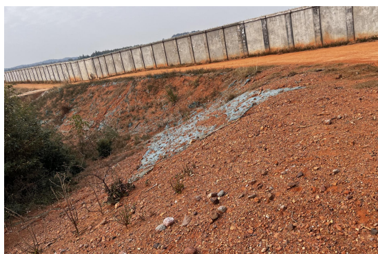
飞行区西北侧临时苫盖破损及植被成活率不高
