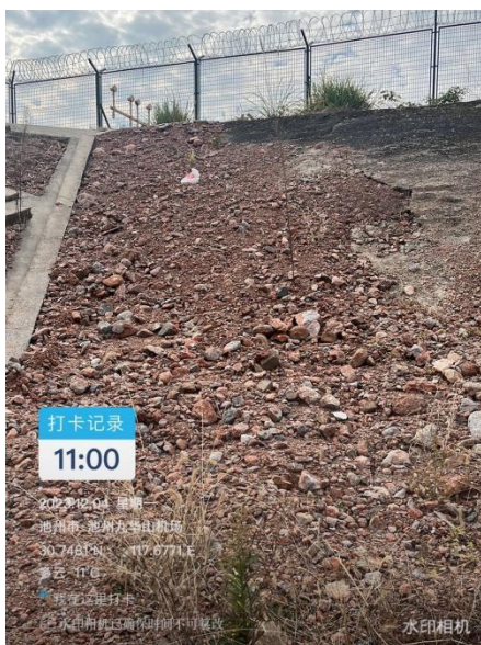
飞行区延长线段衔接处未护坡
